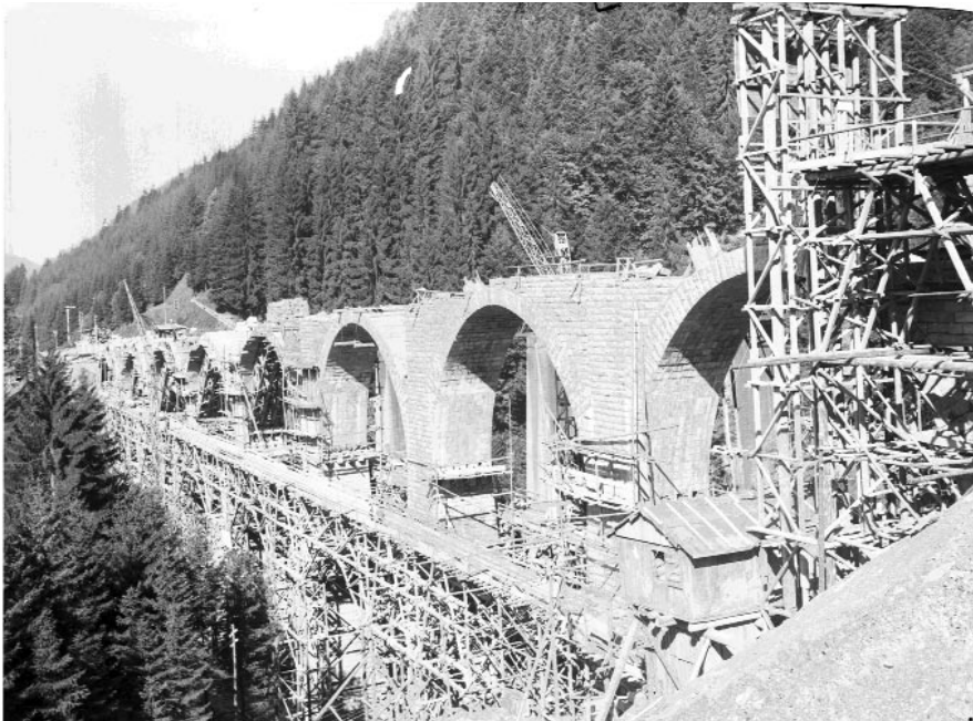
Aufmauern der Bögen des neuen Höllentalbahn-Viadukts, 20. September 1927. Aufnahme: Sepp Allgeier. Vorlage: Staatsarchiv Freiburg T 1 Nachlass Tröndle, Wilhelm Nr. 156
